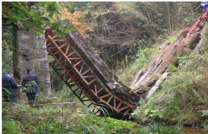
無名橋（香川・徳島県境） 2007年落橋（架設1952年～約54年経過時）
