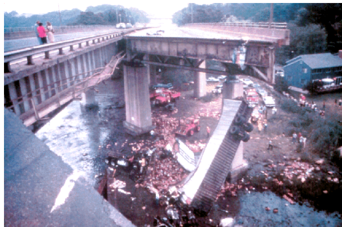
マイアナス橋（米国コネチカット州） 1983年落橋（架設1958年～約25年経過時）
