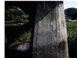
下部工の損傷状況(ひびわれ)
