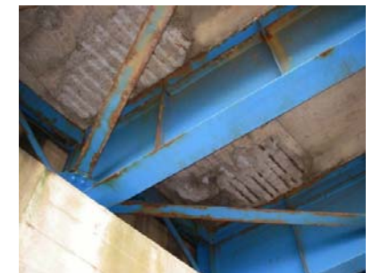
・C判定(剥離・鉄筋露出)
