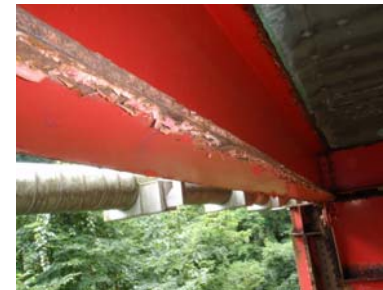
・B判定(腐食)
