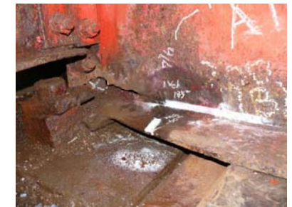
・E判定(腐食・亀裂)
