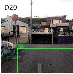
D20 Alligator crack
