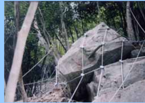
写真 落石対策の事例 (香川県財田町、国道32号)
