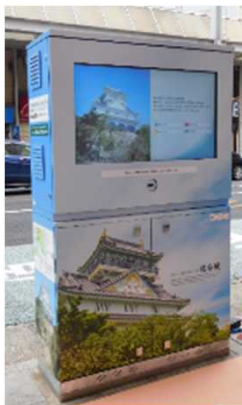
<路上変圧器を活用した事例>
