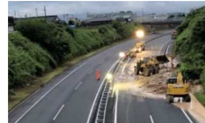
九州自動車道（横川～溝辺鹿児島空港）の被害状況
