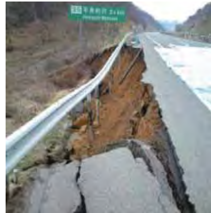
東北道(水沢IC~平泉前沢IC)の被災状況
