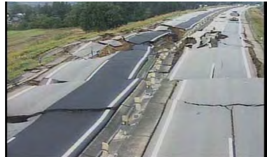
<関越道の被災状況>
