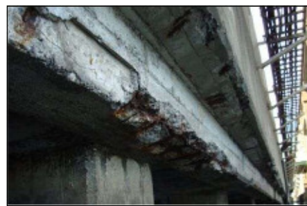
桁下の損傷状況
