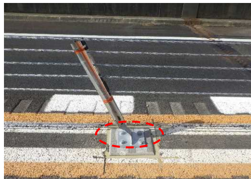
支柱は基部(弱部)の変形のみ
