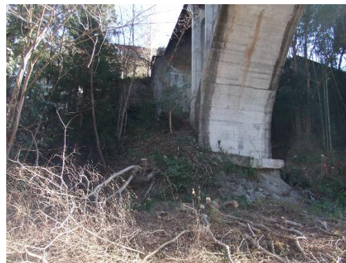
橋台部斜面の変状 (洗掘)
