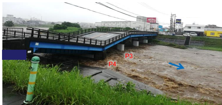
豪雨による洗掘被害 (R3. 7)
