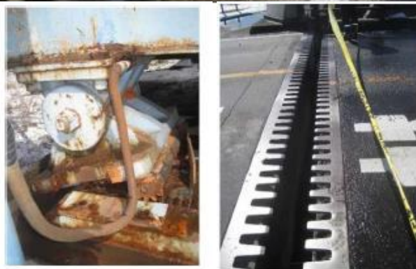
地震による被災 (R4. 3福島県沖地震) 支承の損傷による通行不能
