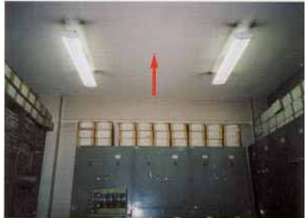
石綿含有パーミキュライト吹付 (天井)
