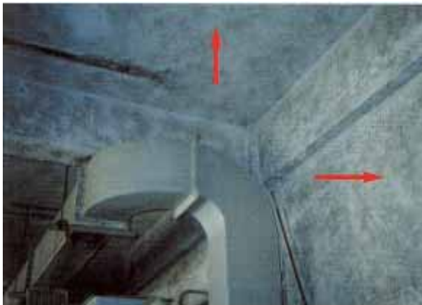
吹付アスベスト・石綿含有吹付ロックウール (吸音用)
