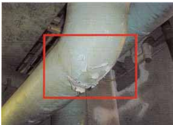
石綿含有保温材 (配管曲がり部)
