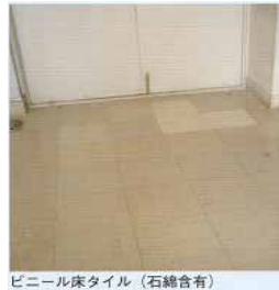
ビニール床タイル (石綿含有)
