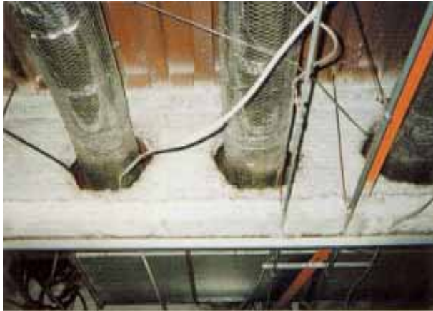
吹付アスベスト・石綿含有吹付ロックウール (S造の耐火被覆)
