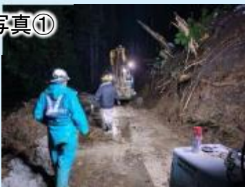
県道38号被災状況
