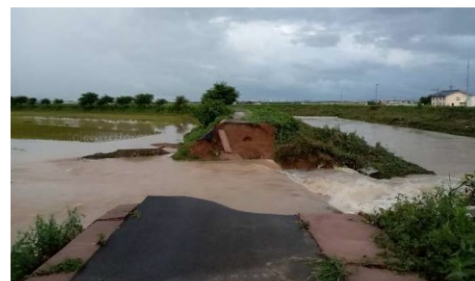
川水系鍋谷川の堤防決壊 （石川県小松市）
