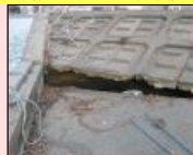
クラックが生じた河川護岸
