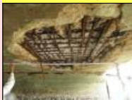
内部の鉄筋が露出した橋梁
