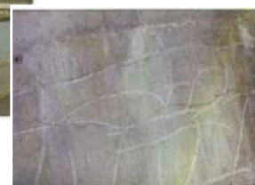
下部工のひび割れ
