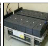
蓄電池の増設
