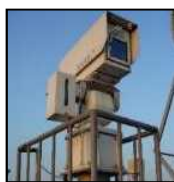
監視カメラの整備
