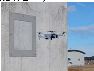
ドローンによる損傷把握
