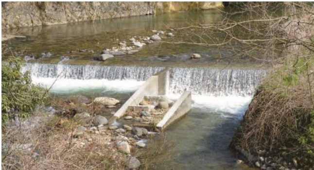
①過去に設置された魚道が破損
