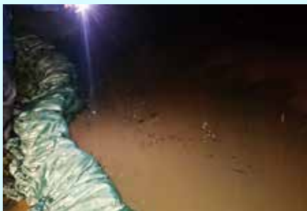
青森県鶴田町消防団 積み土のう工を実施 (令和4年8月9日~12日: 岩木川左岸)
