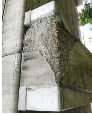
下部工の剥離鉄筋露出
