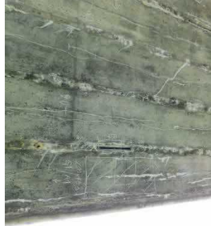
主桁のひび割れ
