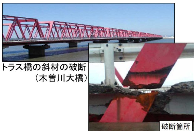
図表 3-7 インフラ施設の損傷の例
