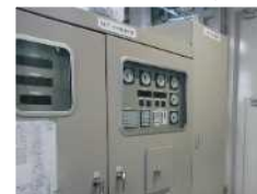
遊水地制御設備
