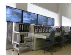
ダム管理用制御設備
