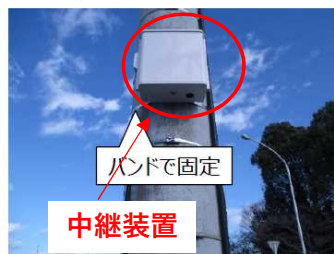
電柱などバンドでの取付け
