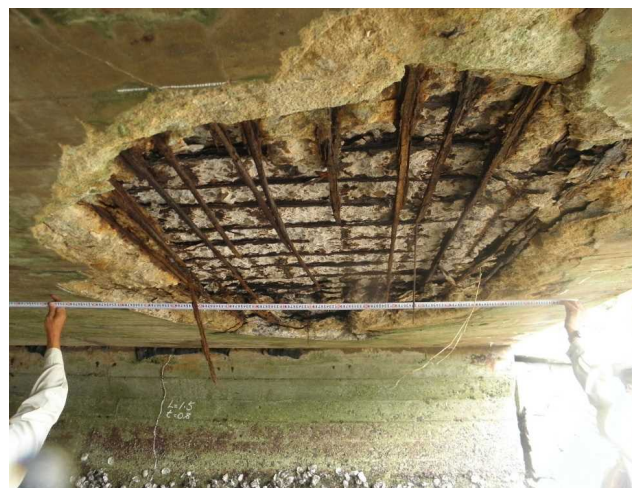
地方自治体管理 床版鉄筋露出
