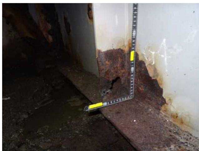
国管理 主桁腐食・欠損
