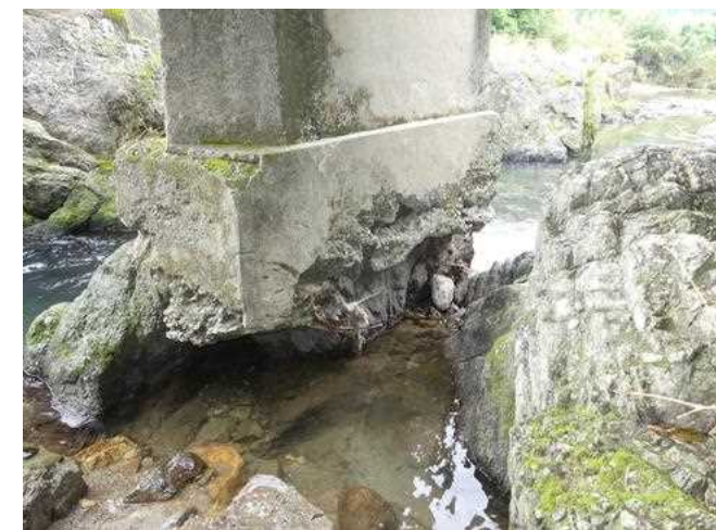
地方自治体管理 橋脚洗掘
