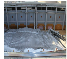
体育館の屋根崩落被害(埼玉県)
