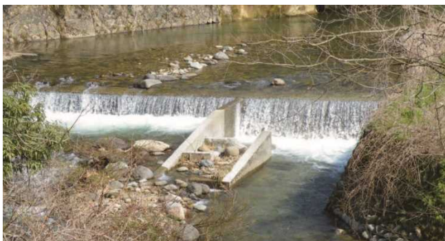
①過去に設置された魚道が破損
