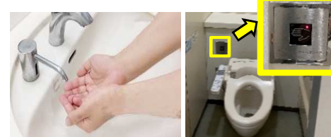
自動水栓・水石けん供給栓 自動洗浄装置
