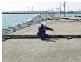
津波警報解除後の現地調査(陸上)
