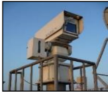
＜監視カメラの整備＞
