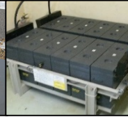
＜蓄電池の増設＞
