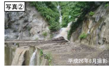
【林道】降雨による路体崩壊
