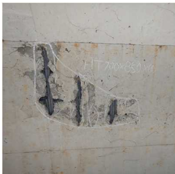
床版下面の剥離
