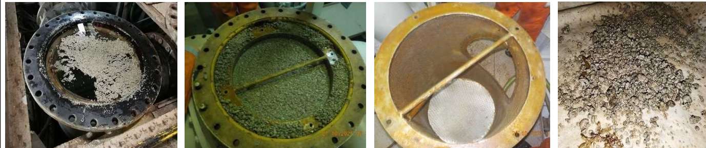
軽石の詰まったエレメントの清掃の様子（外航海運事業者 提供）
