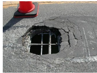
【道路が損傷した例】
