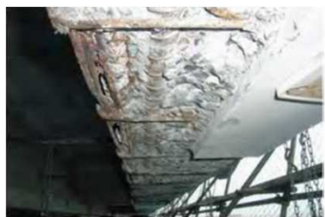
【塩害等による橋梁の鉄筋腐食】
