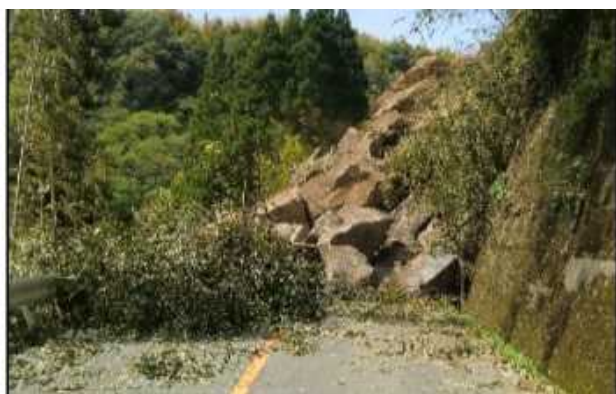
災害発生状況 国道445号 (平成28年 熊本地震)
