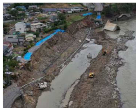
河川の出水による市道の被災状況(長野県東御市)
