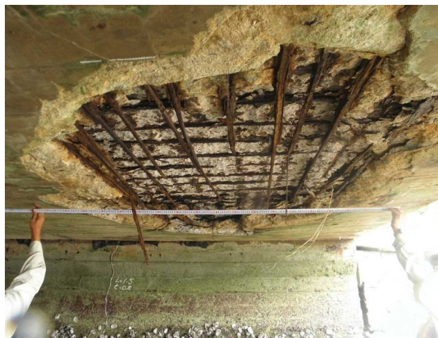
地方自治体管理 床版鉄筋露出
