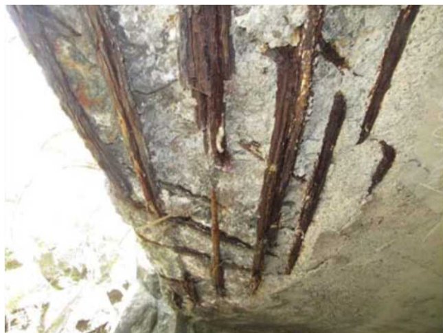
国管理 床版鉄筋露出 ※床版:橋の裏側
