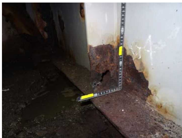
国管理 主桁腐食・欠損
