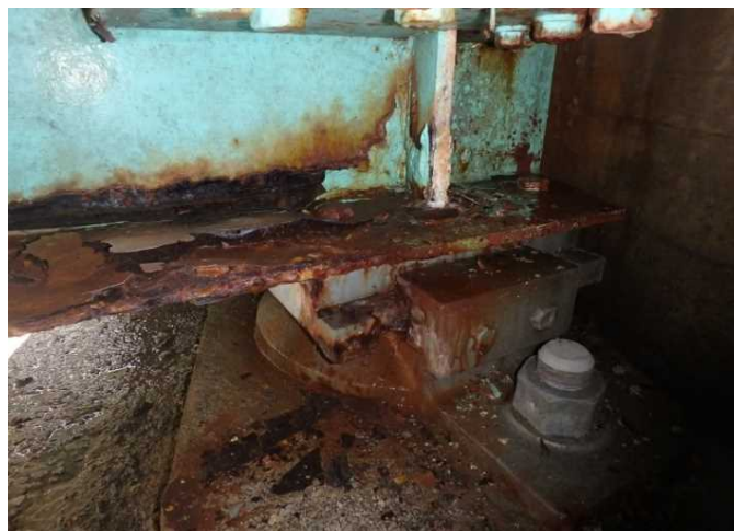
地方自治体管理 主桁腐食
