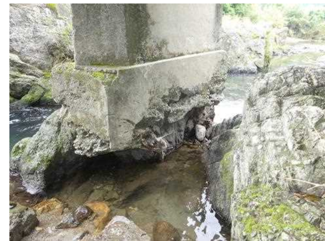
地方自治体管理 橋脚洗掘
