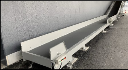
荷物搬送設備【横浜港】
