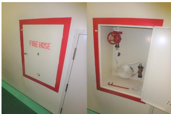
屋内の消火栓とホース
