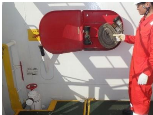
屋外の消火栓（左下）とホース
