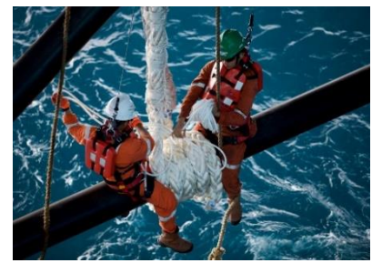
落水の危険がある作業時
