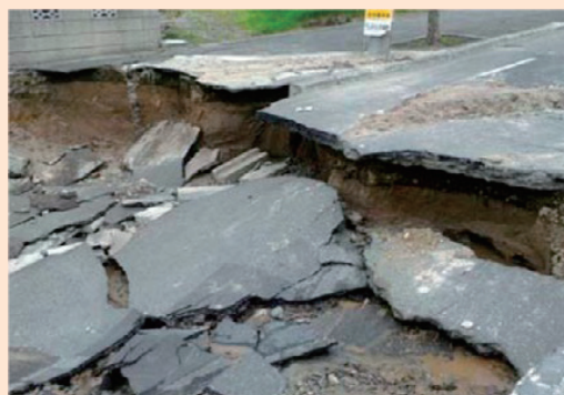
図表2-2-4 地盤沈下により道路が陥没（札幌市清田区平岡地区）
