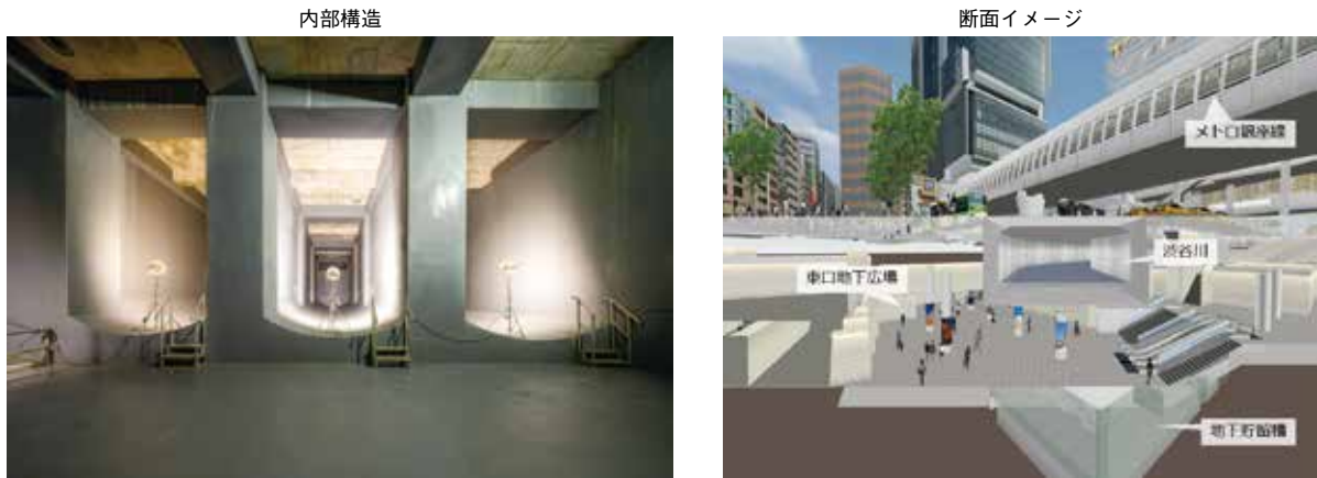
図表1-3-10 渋谷駅東口雨水貯留施設の内部構造と断面イメージ
