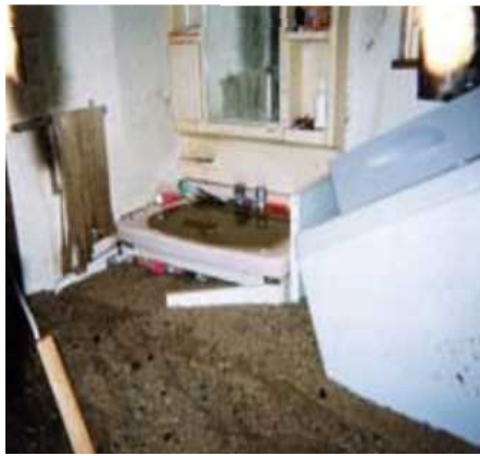
図 1-5 洗面台に堆積物が溜まる例 (資料／国土交通省中国地方整備局太田河川事務所「平成 11 年広島土砂災害」)
