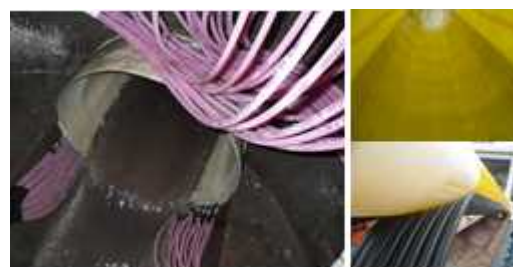
管口部の状況（新潟県十日町市） 内表面と保護層下部
