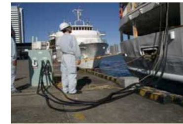
船舶への陸上電力供給
