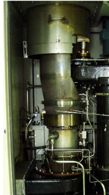
ガスタービン(外観)
