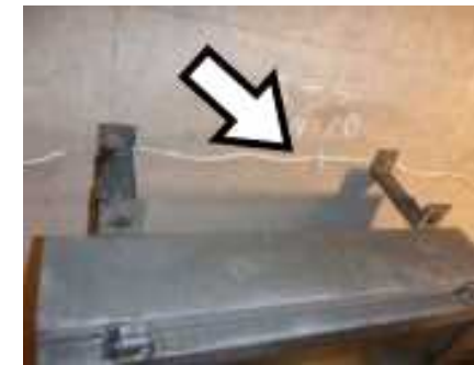
▲照明本体取付部の覆工 コンクリートのひび割れ
