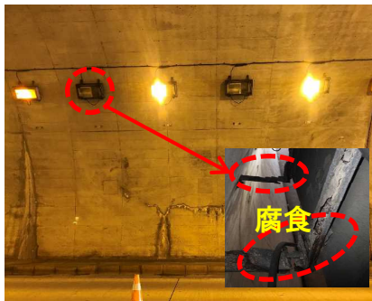
▲附属物取付部の腐食
