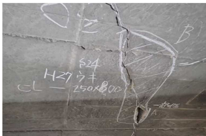
【覆工のうき・はく離】
