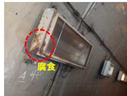
▲照明本体の腐食
