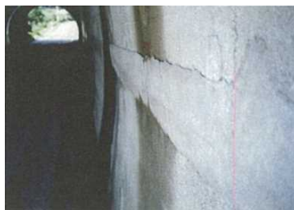
▲打継ぎ目の化粧モルタルがういている状態
