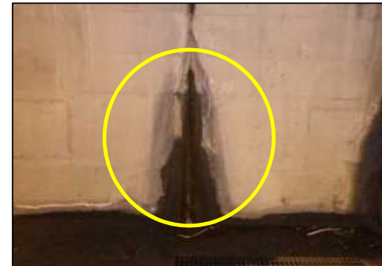
【覆工からの漏水】
