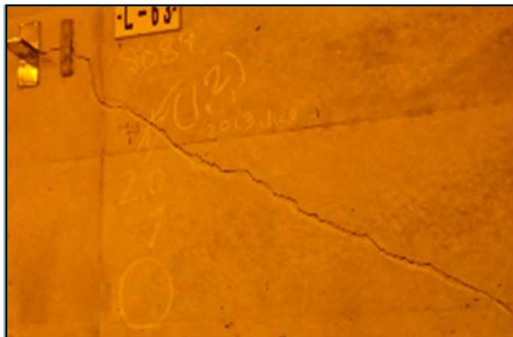
【覆工のひび割れ】
