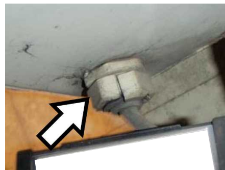
▲附属物のナットの破断
