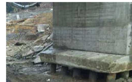
杭基礎の露出
