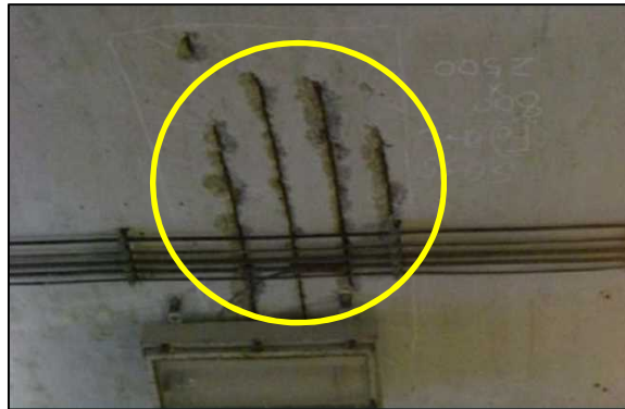
【覆工鉄筋／附属物の腐食】
