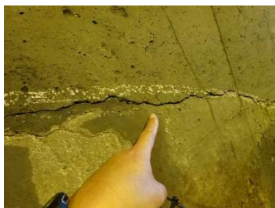
▲覆工表面のひび割れ
