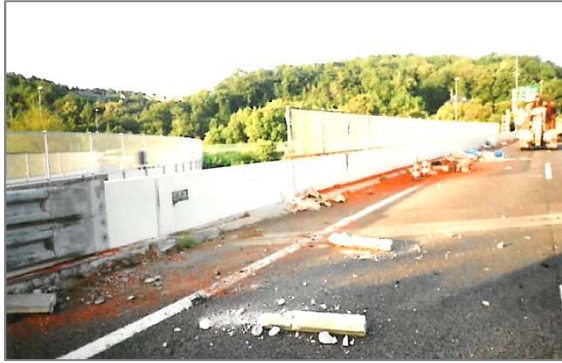
写真6-1 側壁の損傷状況
