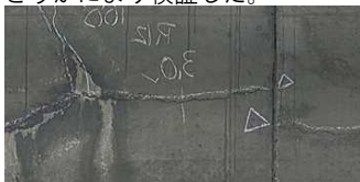
写真3 実トンネルにおけるチョーキングを伴うひび割れの例
