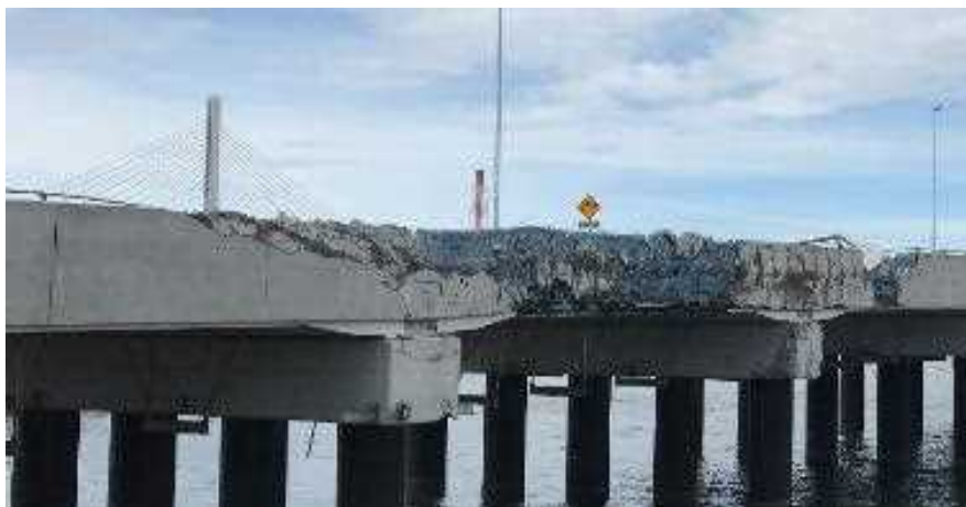
<横浜港 南本牧はま道路の損傷>
