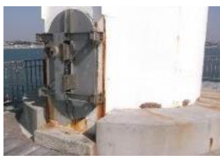
〔灯台基礎部の発錆状況〕
