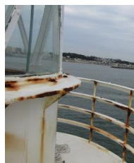
〔灯台上部の発錆状況〕
