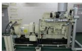
非常用発電機
