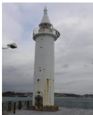
〔灯台外部の発錆状況〕
