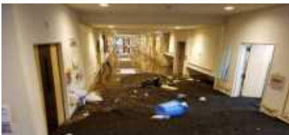
施設1階に土砂が大量に流入したが、全員無事
