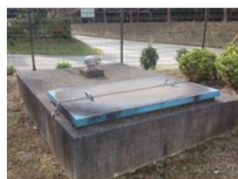
神崎町水道 古原浄水場水源1号井 【出典】千葉県より提供
