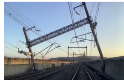
東北新幹線の電柱傾斜
